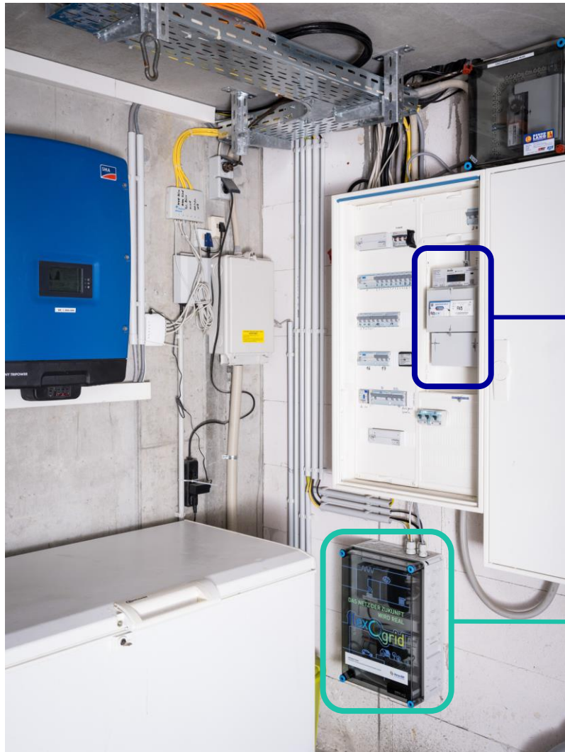
Smart Meter und Steuerbox
