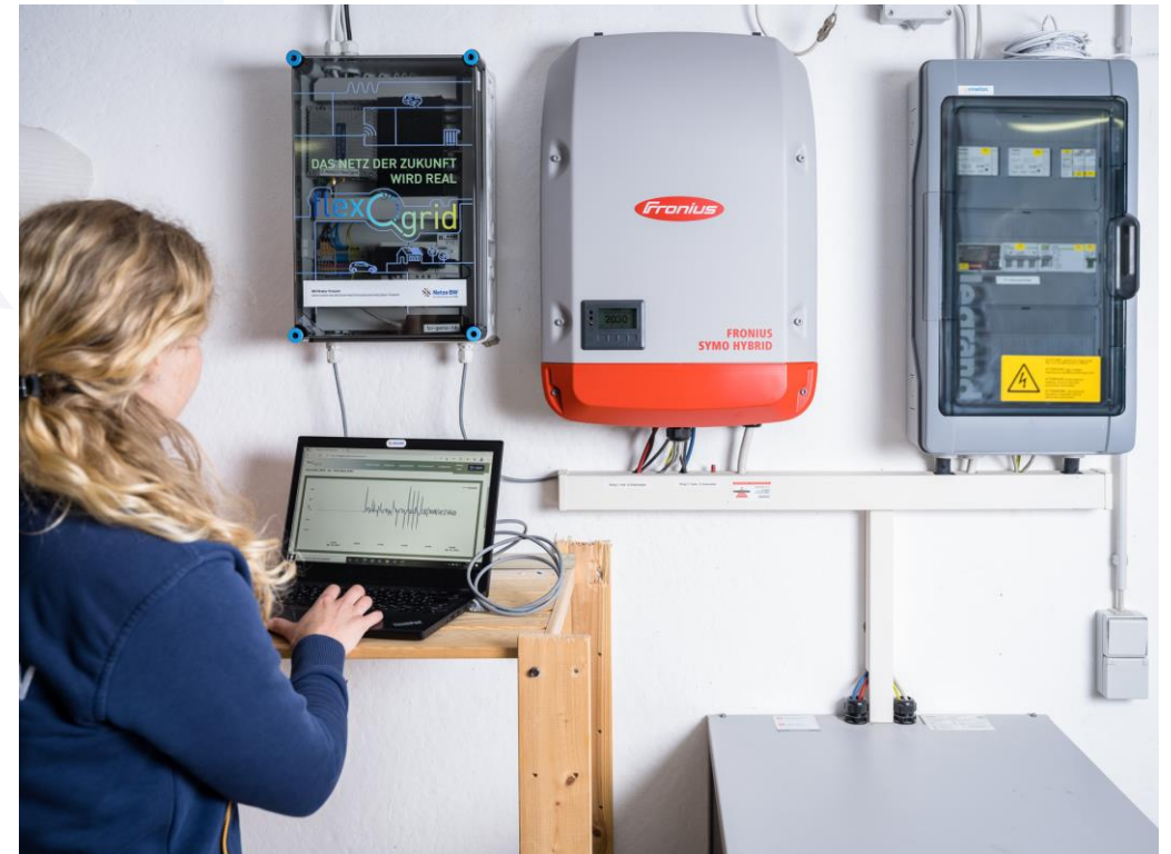
Unterschiedliche Schnittstellen bei Bestandsanlagen
